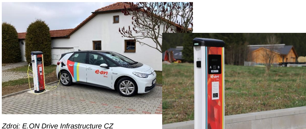
Obrázek 1: AC dobíjecí stanice
