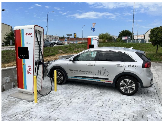
Obrázek 2: DC dobíjecí stanice
